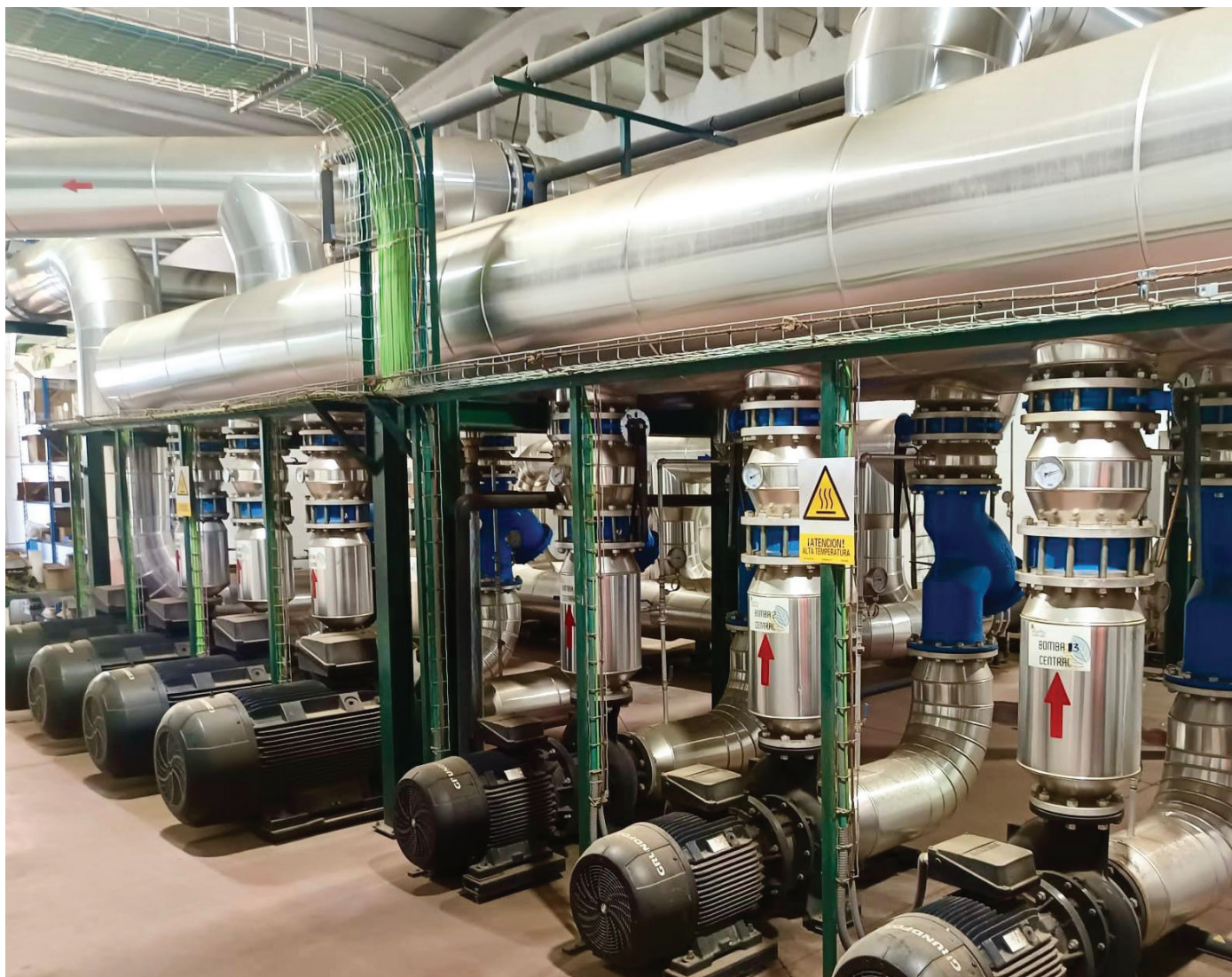
La infraestructura sostenible duplica su potencia de producción con un nuevo equipo de 14 MW.
