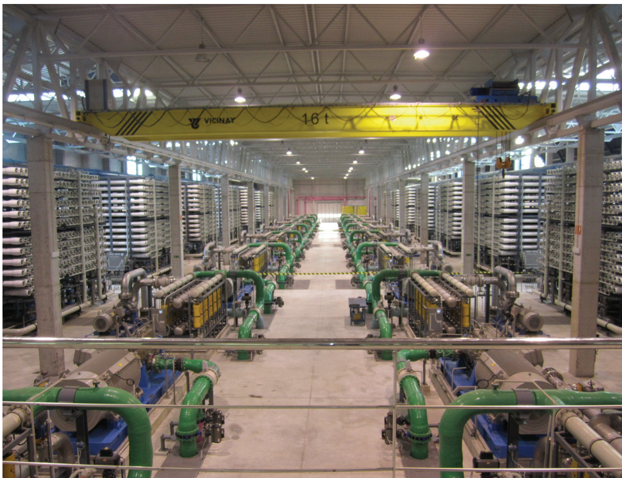
Sala de ósmosis de la desaladora de Torrevieja | Osmosis plant at the Torrevieja desalination plant
