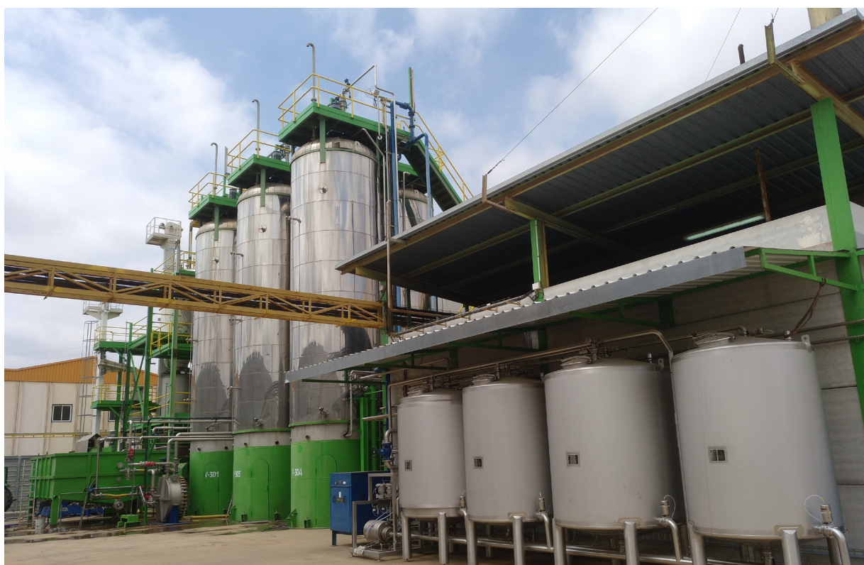
FIGURA.7. Imagen de las instalaciones de Perseo Biotechnology
