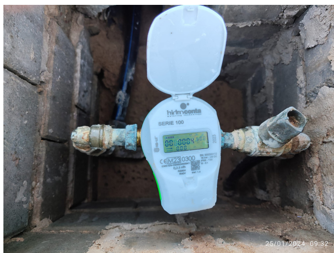
Contador inteligente CENTAURUS instalado en la Urbanización Cruz de Gracia / CENTAURUS smart meter installed in Cruz de Gracia residential estate
