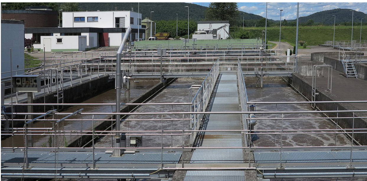
Canales de aireación en una planta municipal de tratamiento de aguas residuales.
